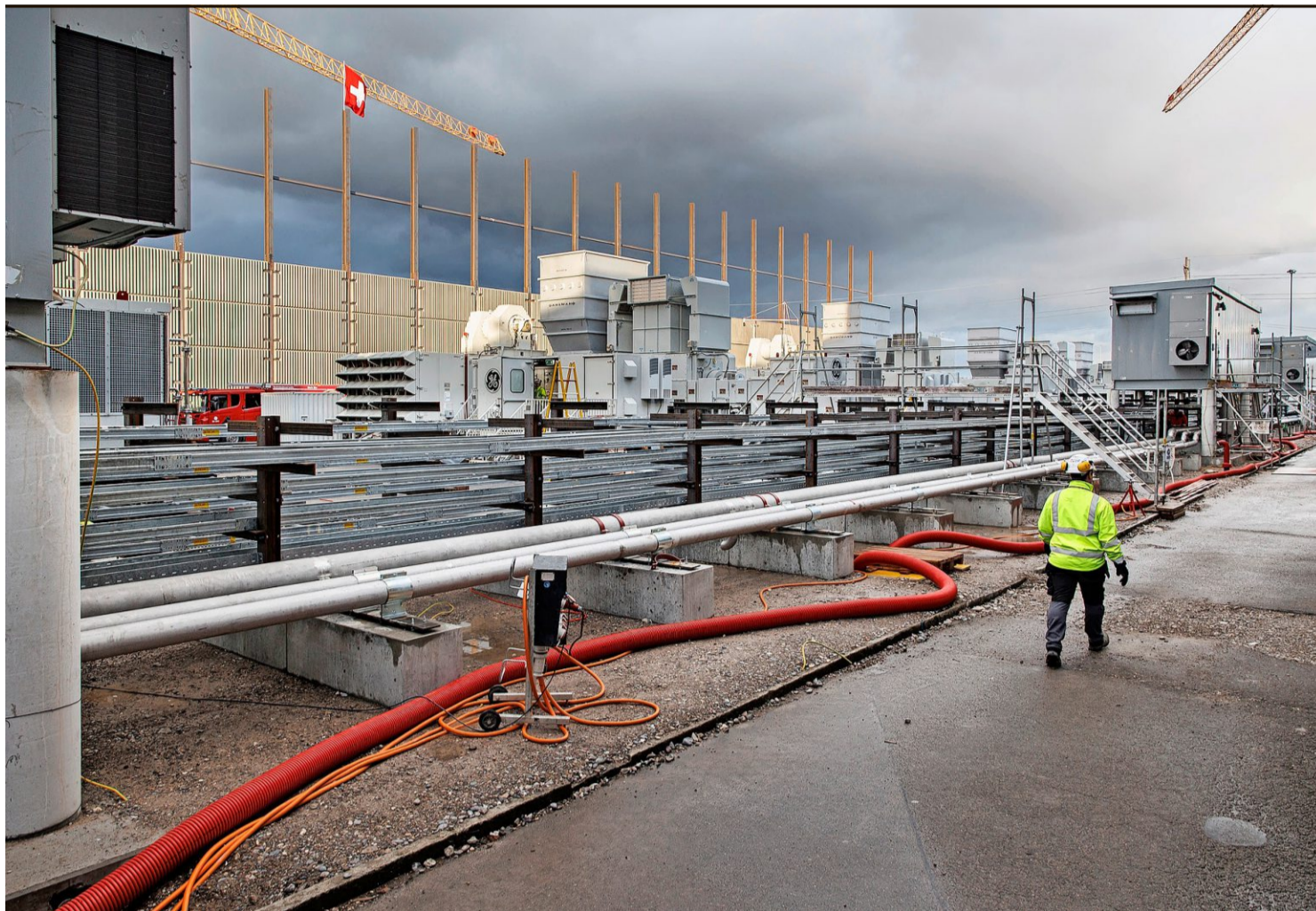
Das Notkraftwerk mit Gasturbinen-Generatoreinheiten soll ab Ende Februar in Birr AG zur Verfügung stehen. Foto: Dominique Meienberg
